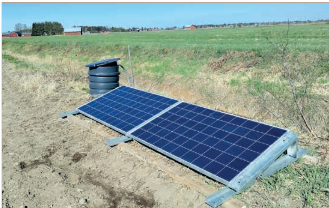
Kastelujärjestelmät saavat virtansa pääosin aurinkopaneeleista.
